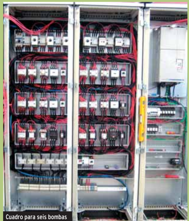
Cuadro para seis bombas
