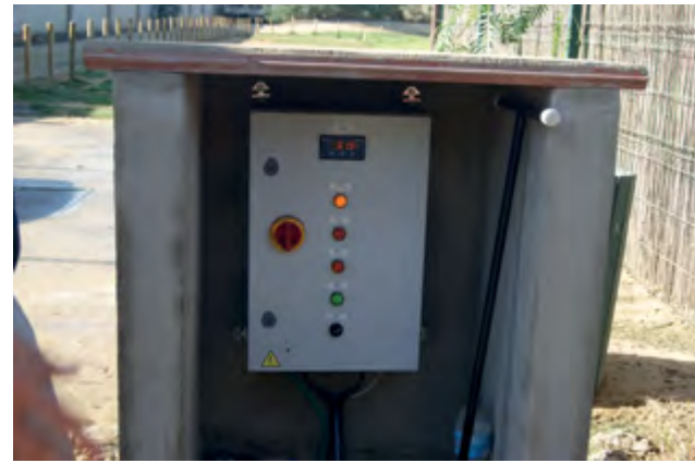
Panel de control de sonda de humedad.
