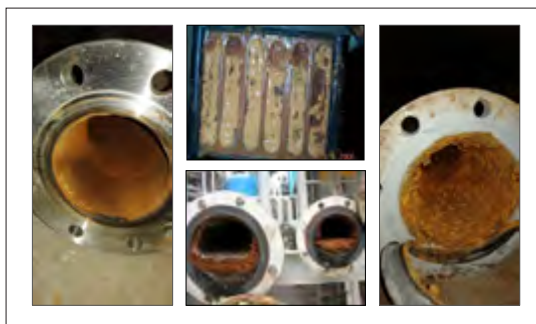
Tubería con corrosión con un alto nivel de biocapas. Fuente de Legionella
